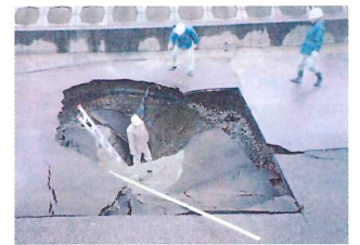
吸い出し・陥没被害の発生
