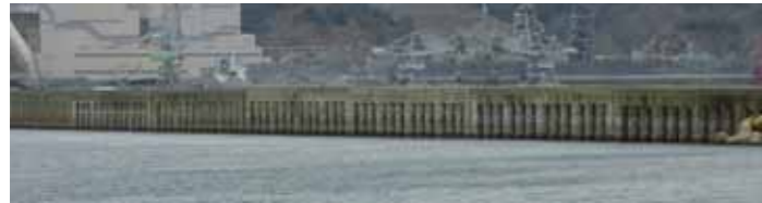
港外側から見た縦スリットケーソン堤のスリット部分
